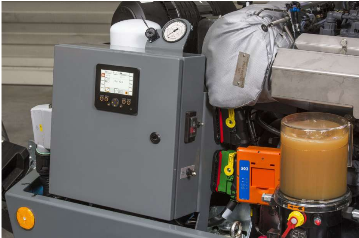
Wyświetlacz z elementami obsługi w szafie sterowniczej pod okapem
